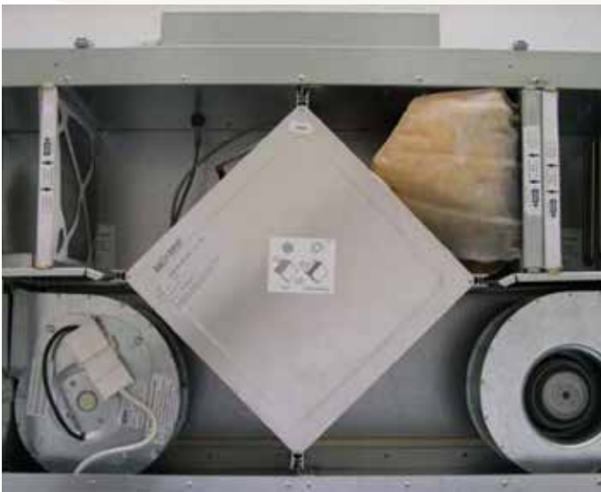
Impianto di ventilazione centralizzato
