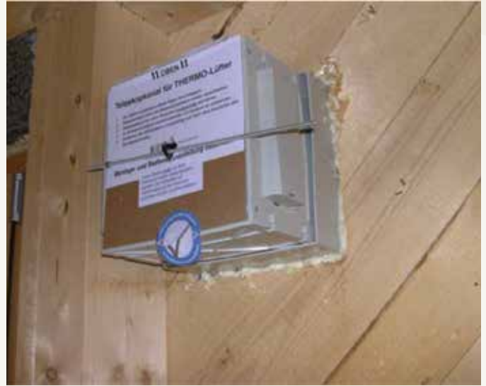
Impianto localizzato di ventilazione con recupero di calore
