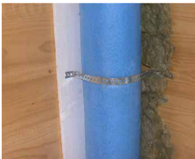
Tubazione di scarico ricoperta con materiale fonoisolante
