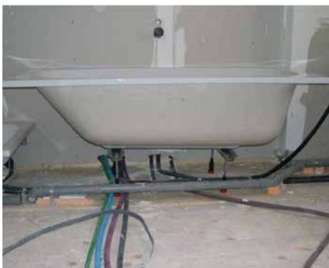
Impianti di adduzione e scarico per vasca
