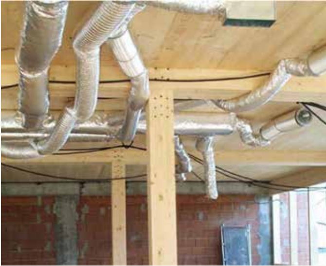
Passaggio a soffitto di tubazioni per impianto centralizzato di ventilazione con recupero di calore
