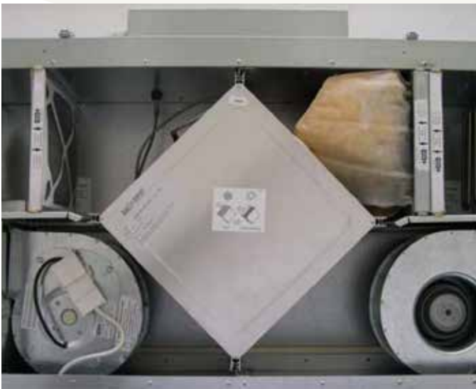
Impianto di ventilazione centralizzato
